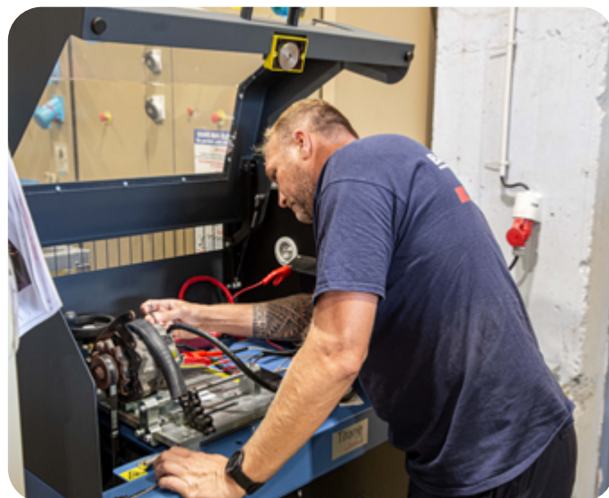
L'atelier électricité entretient et répare les moteurs électriques et les automates embarqués.
