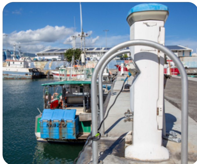
Borne de raccordement électrique au port Ouest.
